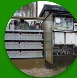
LVDC microgrid, 2014 (Suur-Savon Sähkö/LUT)
